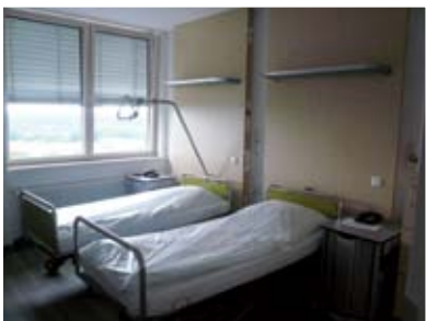
Das Foto zeigt ein 2- Bettzimmer mit Wandpaneelen, in die die Installationseinheiten integriert sind
